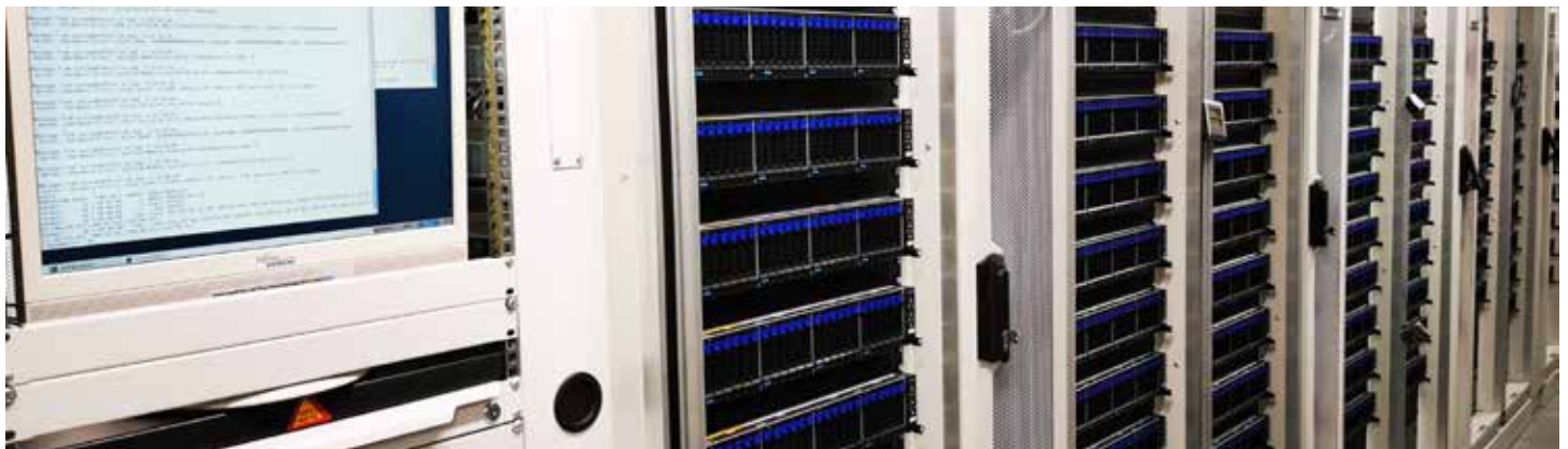
Bild: Blick in den Serverraum des BZHPC
